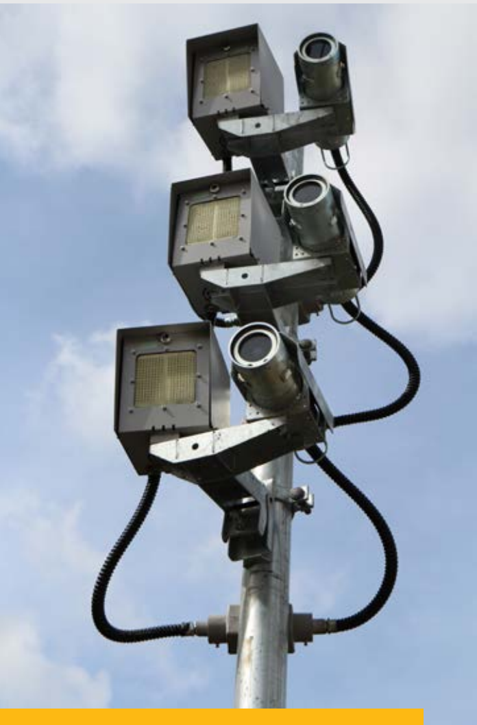
Radar implantado em rodovia do estado de São Paulo. Fonte: Arquivo IPT.
